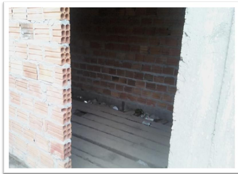
Figura 27 : Sanitário improvisado em escola da região de terra firme.
