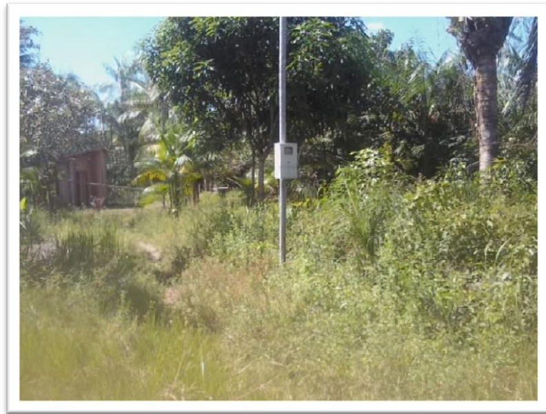
Figura 14 : Poste e caixa de registros de energia elétrica Fonte: Arquivo da pesquisa, 2012.
